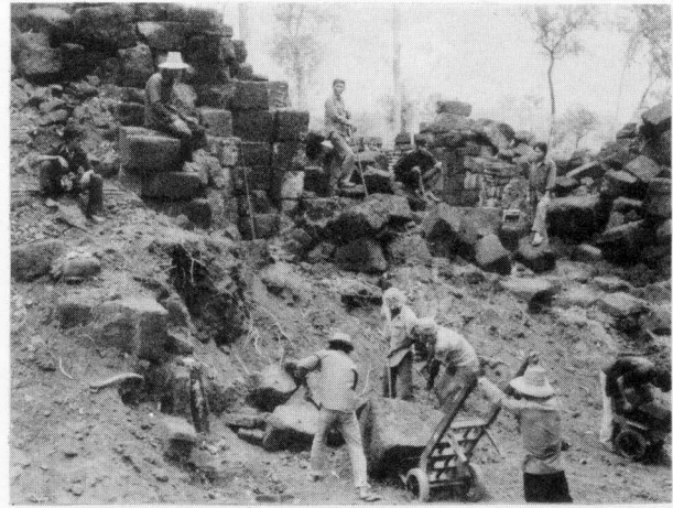
๕-๑๐ บริเวณปรังก์ประธานด้านทิศตะวันออกเฉียงเหนือ คนงานกำลังทำงาน
