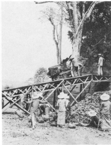
๑-๔ สะพานที่สร้างขึ้นสูง ๓.๐๐ เมตร ยาว ๑๒.๐๐ เมตร กว้าง ๒.๐๐ เมตร เพื่อขนก้อนศิลาแดงที่พังทับถมบนบริเวณเทวสถาน คนงานกำลังนำก้อนศิลาแดงเข็นลงสะพาน เพื่อนำมาเรียงให้เป็นระเบียบ ซึ่งง่ายแก่การที่จะนำมาบูรณะต่อไป
