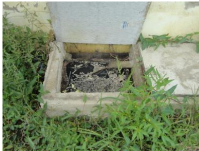
รูปที่ 5-13 บ่อดักไขมันจากน้ำที่จากโรงอาหารของโรงเรียนบ้านคลองสว่างอารมณ์
