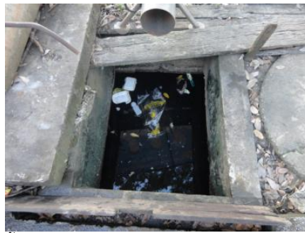
รูปที่ 5-30 ท่อรับน้ำทิ้งจากชุมชนและโรงงานในซอยไร่ชิง 42 ซึ่งปล่อยลงสู่คลองยายสา
