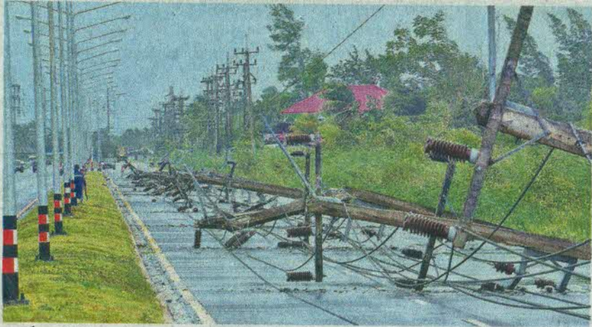
ฤทธิ์'ปาบิก' - เสาไฟฟ้าใน อ.ปากพวง จ.นครศรีธรรมราช ถูกแรงพายุปาบิกพัดจนล้มระเนระนาด ส่งผลให้ไฟฟ้าดับทั้งเมือง เมื่อวันที่ 4 มกราคม
