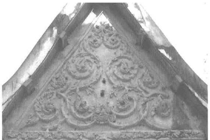
หน้าบันที่ 8 (ทิศตะวันตก) ปั้นลายหน้าชบคาบลายก้านชด หน้าบันด้านนี้มีร่องรอยชำรุดตรงกลาง เป็นไปได้ว่าครั้งหนึ่งอาจเคยปั้นตัวกับลาย ซึ่งบัดนี้ได้หลุดหายไปเสียแล้ว
