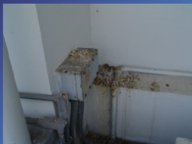
มูลนกรอบอาคาร
